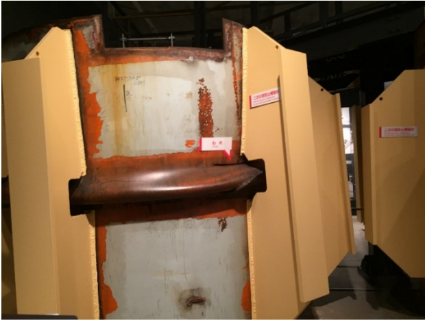
円形鋼管柱の座屈と鋼板溶接による応急補修
